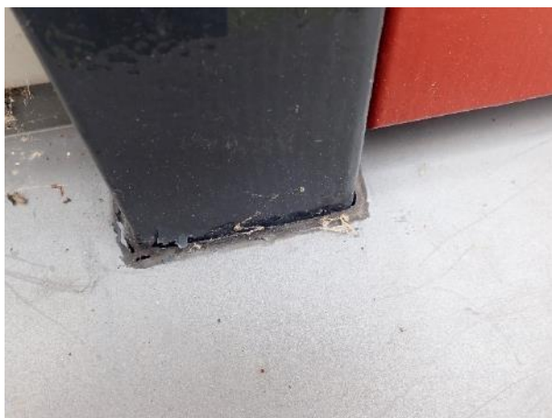
Foto 3.2.9: loslaten van kitrand tussen de metalen neuslat en kozijnhout ter plaatse van tussenstijl kozijn.
