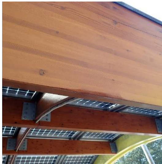
Foto 3.4.4 Aanrijshade aan ligger A welke is gerepareerd.
