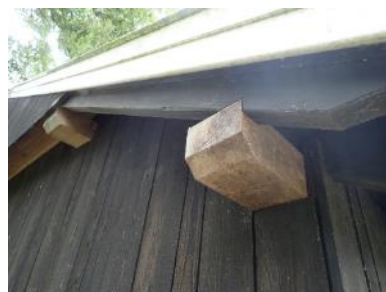
Foto 3.11.12 Risicovolle detaillering, echter zonder schade.
