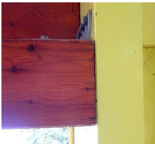
Foto 3.4.7 Zeer lichte vorm van inwateren in de kopse kant van de ligger.
