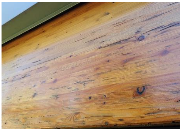
Foto 3.6.3 Verkleuringen door inwatering.
