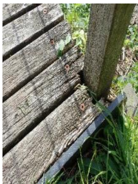
Foto 3.9.14 Dek aansluiting weg, aantasting eerste planken.
