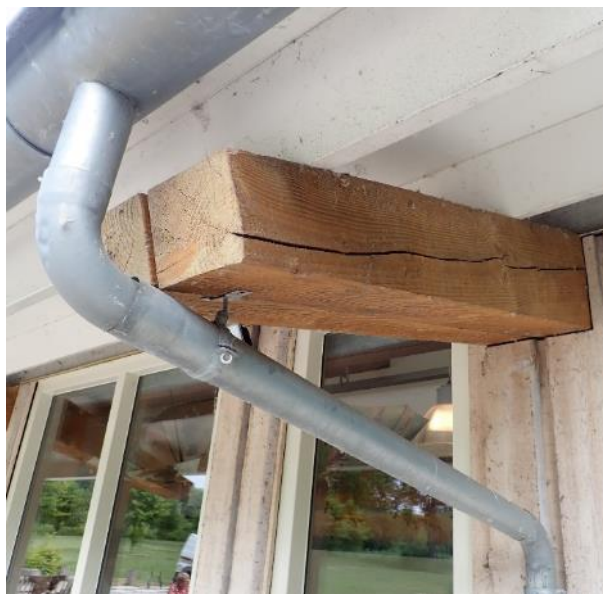
Foto 3.7.7 Het plaatsen van een hemelwaterafvoer ter plaatse van de douglas spanten brengt risico met zich mee.
