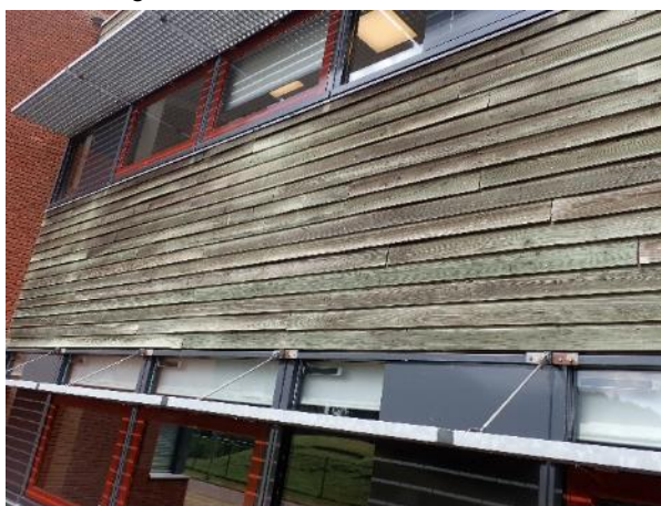
Foto 3.2.5: Gevelbekleding (zuiden), niet geheel strak door schotelen.
