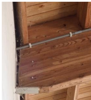
Foto 3.3.4: Oplegdetail. De spanten zijn tegen de betonnen muur opgelegd m.b.v. een RVS schoen en twee stiften.
