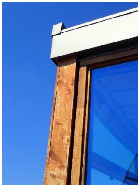
Foto 3.6.8 Coating ter plaatse van sterrenwachtoren is verweerd.
