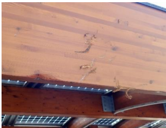
Foto 3.4.5 Aanrijshade aan ligger B met splinters en verschade welke deels is gerepareerd (linksonder).
