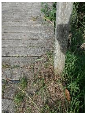
Foto 3.9.13 Dek aansluiting weg, aantasting eerste planken.
