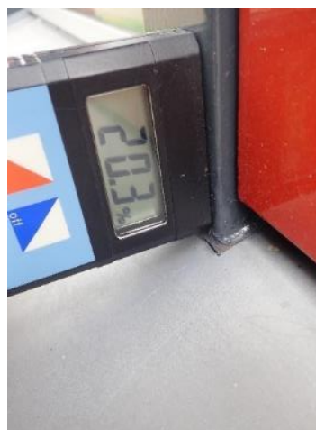
Foto 3.2.10: Hoog houtvochtgehalte aan de onderzijde van de tussenstijl.
