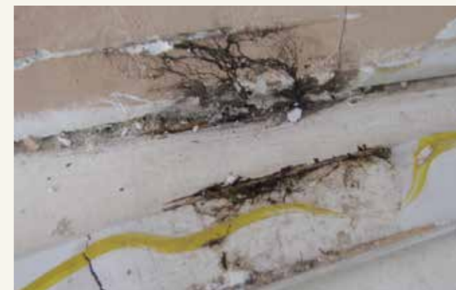
Draden van kelderzwam achter een losgehaalde houten plint. Foto: SHR
