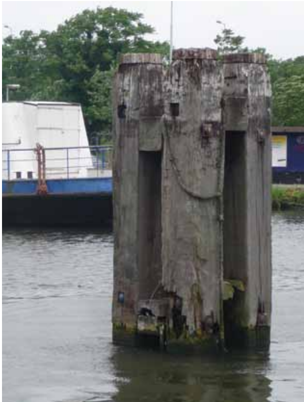
Grote oude paaljukken op de Schie waar te zien is wat de consequenties zijn van de vroeger veel gebruikte detailleringen.
