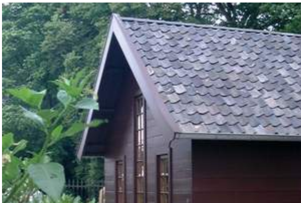
foto gevelbekleding op Twickel van gewaterd grenen /eiken
