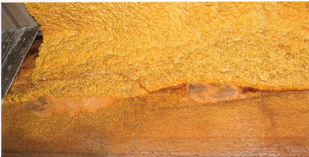
Aangetaste gording; vruchtlichamen van de schimmel op de grens van het schuim en het hout.
